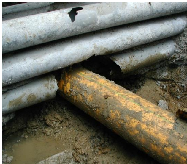
Schaden bei Werkleitungskreuzung
